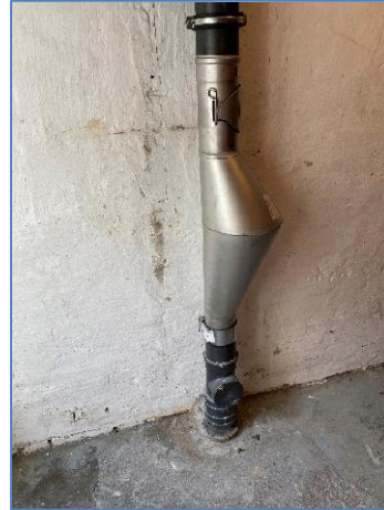
Foto 2: Rottespærring på faldstamme i kælder
