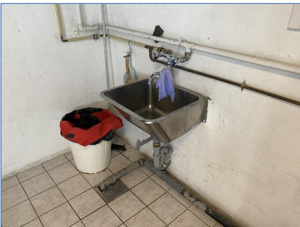
Foto 5: installation i fællesareal
