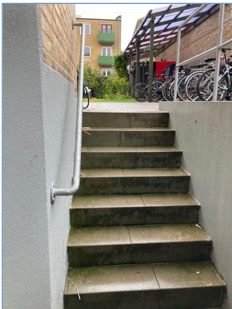
Foto 3: Trappe mangler opkant
