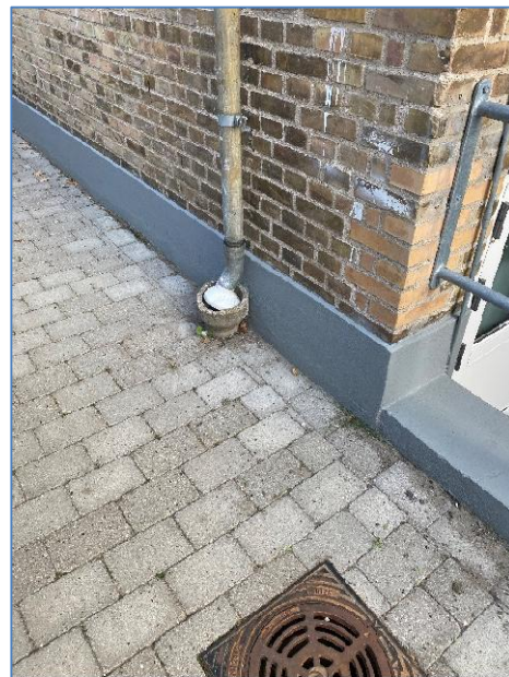
Foto 4: Nedløbsrør samt brønd
