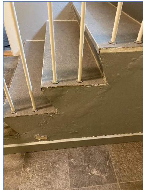
Foto 4: Fugt i trappe til kælder Hyltebjerg Allé 5
