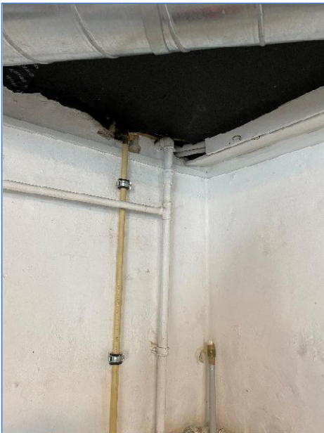
Foto 3: sammenblandet rørmaterialie i vaskerum under HY 9
