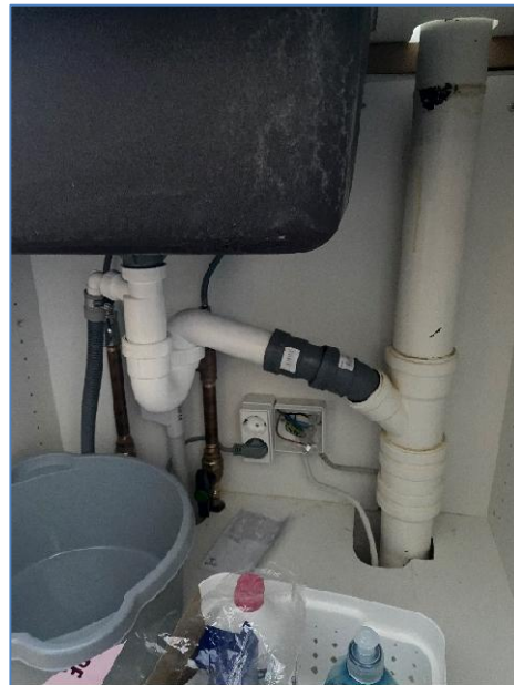
Foto 4: Afløb under køkkenvask
