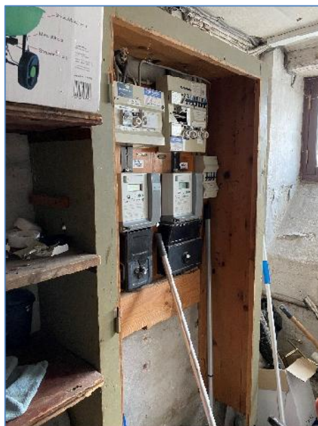
Foto 2: Eltavle i kælder under LA 30A
