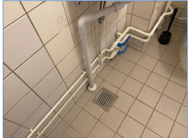
Foto 2: Fordelingsledninger i badeværelset
