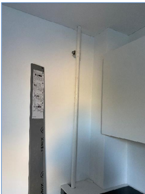
Foto 1: Gasrør i lejlighed
