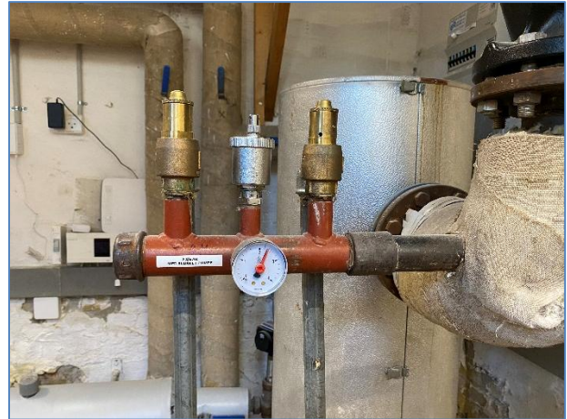
Foto 2: Manometer og sikkerhedsventiler
