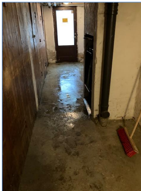
Foto 2: Vand i kælder efter kraftigt regn
