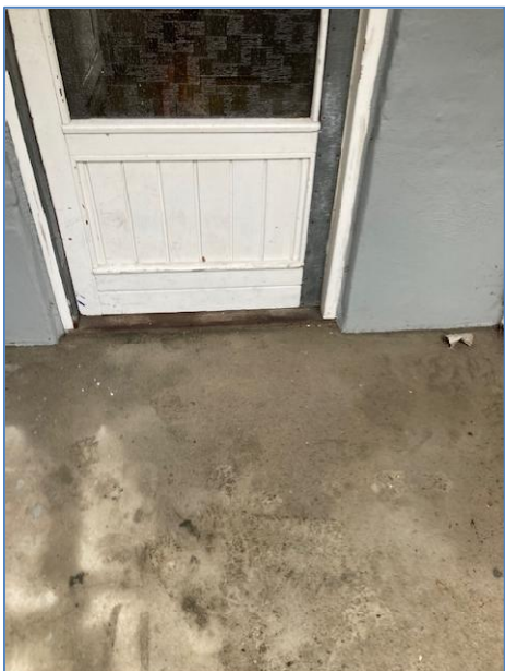
Foto 1: Kældernedgange- vand løber ned til dør.
